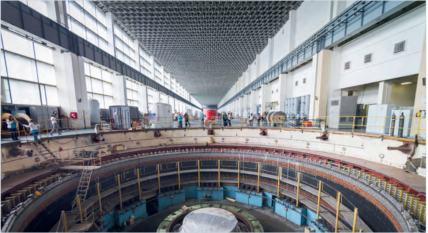
Резонансная установка серии УИГ установлена
